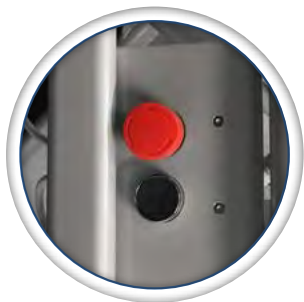
Bajada de emergencia eléctrica
